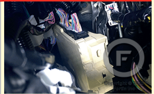
At the back of the Main body ECU - below dash fuse box Au dos du Main body ECU - sous le tableau de bord
