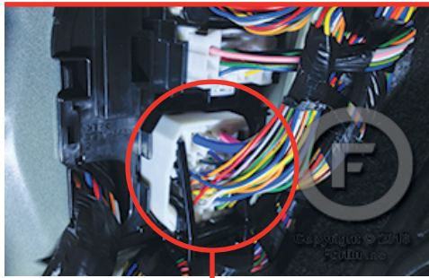
① In the driver's side kick panel Panneau latéral côté conducteur
