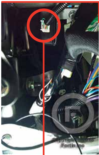
③ At Junction connector, left side of the dash - Au connecteur de jonction, à gauche du tableau de bord
