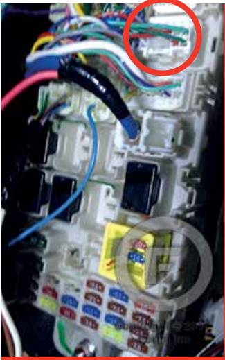
④ ③ Fuse box Boîte à fusibles
