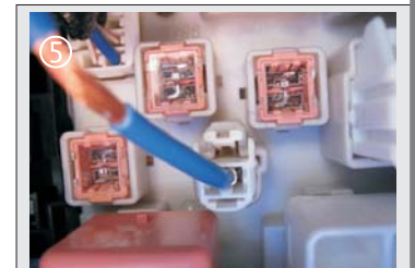
Back view - At fuse box Vue de dos - À la boîte à fusibles
