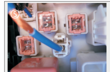
Back view - At fuse box Vue de dos - À la boîte à fusibles
