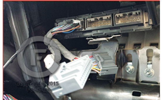
① ② Behind glove box Derrière le coffre à gants
