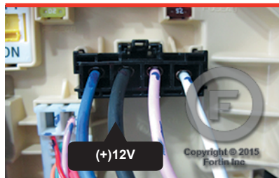
② Front of the use box. Au devant de la boîte à fusibles.
