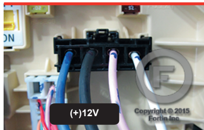
⑤ Front of the use box. Au devant de la boîte à fusibles.
