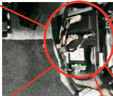
BCM located in passenger kick panel | BCM Situé dans le panneau latéral côté passager
