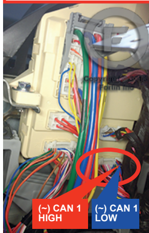
⑥ Behind Fuse Panel Derrière la Boîte à Fusibles
