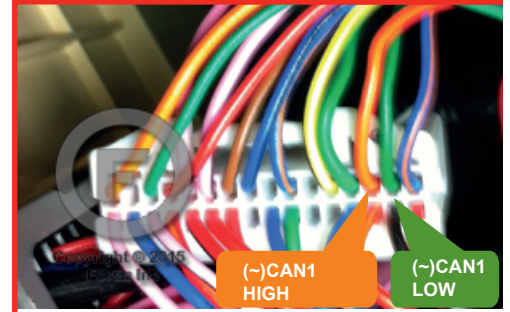
④ Back of fuse box Derrière la boîte à fusibles
