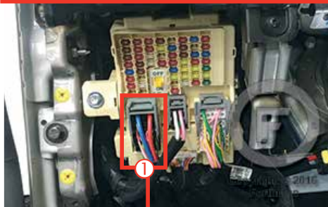
1 Fuse box. Boîte à fusibles.
