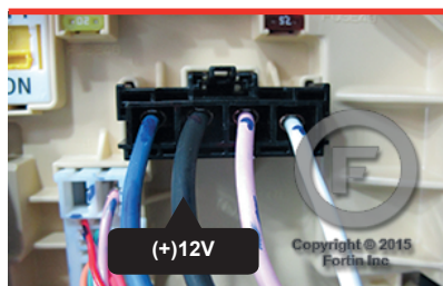
② Front of the fuse box. Au devant de la boîte à fusibles.
