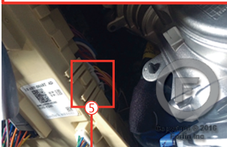
⑤ Back of fuse box Au dos de la boîte à fusibles
