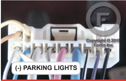
② At Parking light switch harness Au Harnais des feux de stationnement
