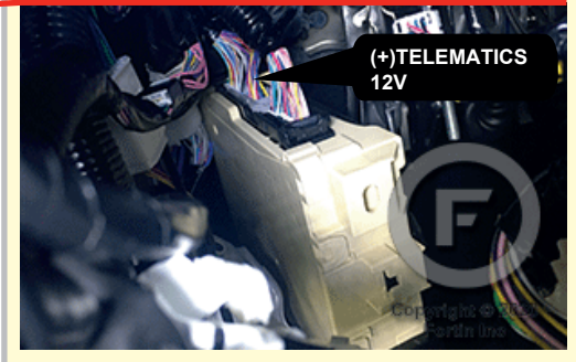
At the back of the Main body ECU - below dash fuse box Au dos du Main body ECU - sous le tableau de bord
