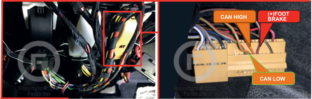
② BCM, Under the dash Driver side BCM, Sous le tableau de bord côté chauffeur
